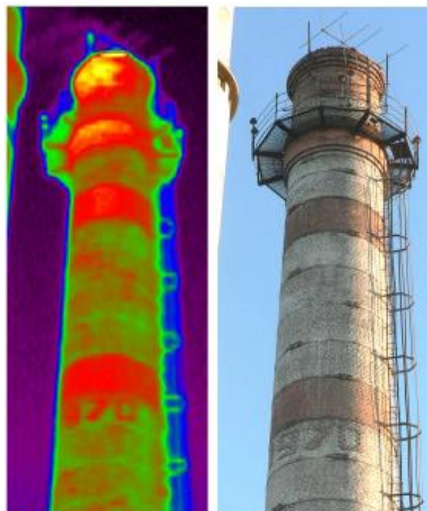
Рис. 1 Термограмма и фотография верхней части дымовой трубы котельной с дефектом оголовка
