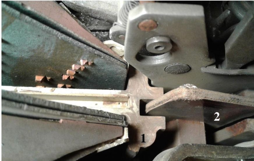
Рис. 4. Фрагмент основания корпуса автоматического выключателя А3792: 1 – электроизоляционное ребро, отделяющее силовые контактные группы полюсов разных фаз и их дугогасительные камеры; 2 – текстолитовая изоляционная вставка, ограждающая механизм свободного расцепления
